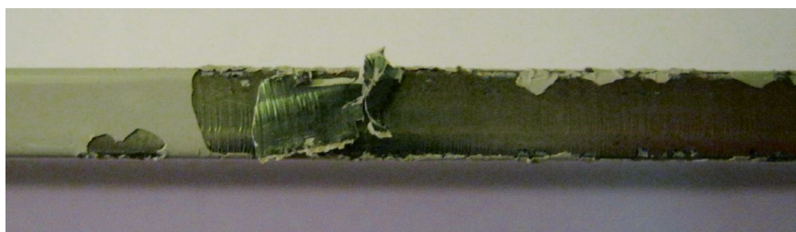
Bild 1 > Mangelnde Haftfestigkeit der Beschichtung durch Zunderschicht: An pulverbeschichteten Bauteilen kam es im Bereich der lasergeschnittenen Kanten zu großflächigem Abplatzen der Beschichtung.
