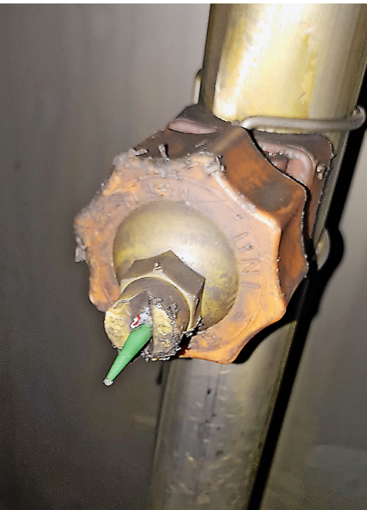
Verstopfte Spritzdüsen sind ein häufig auftretender Fehler in Durchlaufspritzanlagen.
