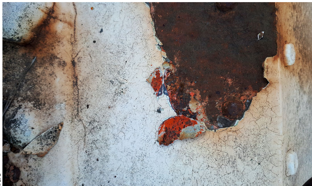
Beispiel eines Schadensbildes: Korrosionsschutzbeschichtung mit Haftfestigkeitsstörungen.
