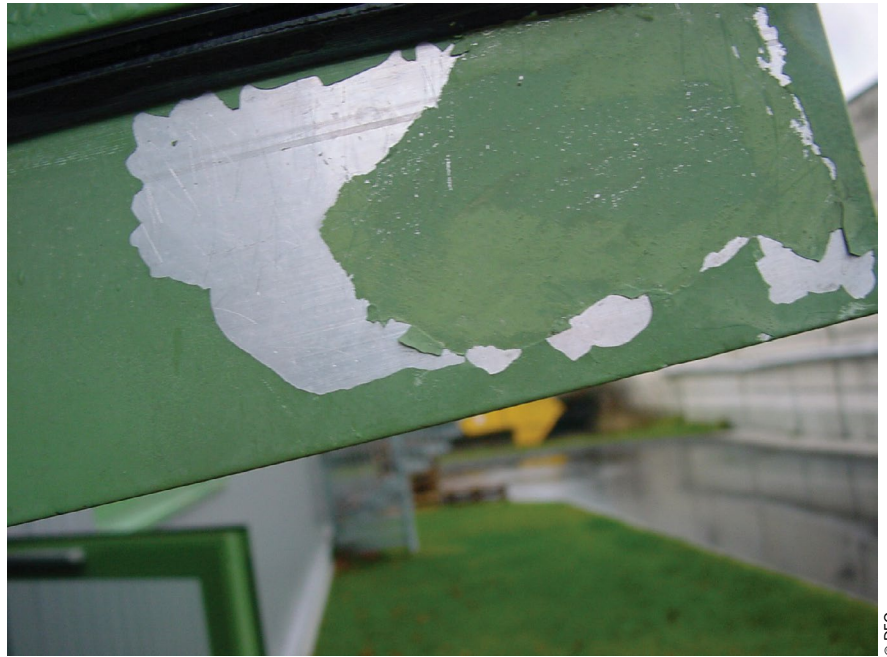
Die Pulverbeschichtung dieses Aluminiumvordachs löst sich ab, weil als Vorbehandlung lediglich eine Eisenphosphatierung stattfand, auf Aluminium ist im Anschluss zusätzlich das Aufbringen einer Konversionsschicht oder Passivierung vonnöten.
