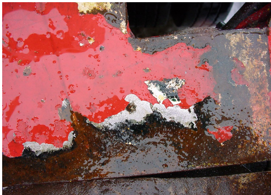
Fehlerbereiche mit abgeplatzter Beschichtung und stellenweise glänzender Substratoberfläche
