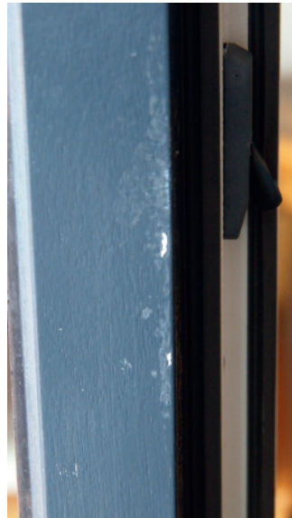
Bild 1: Das Schadensbild zeigt Farbabrissse. Fotos: DFO
