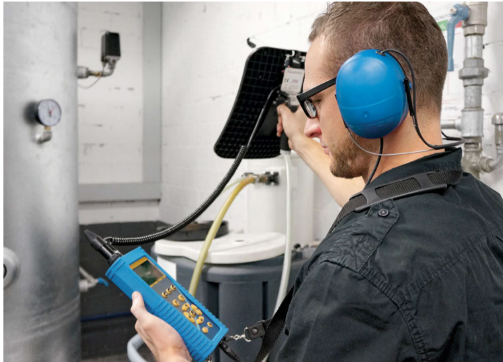
Wenn es pfeift und zischt, ist das kein gutes Zeichen, wenn Druckluft daran beteiligt ist. Zunächst ist dann Leckageortung angesagt und anschließend eine Reparatur notwendig.
